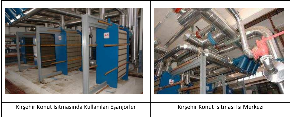
Şekil 50: Kırşehir Şehir Isıtma Sistemine Ait Görseller
